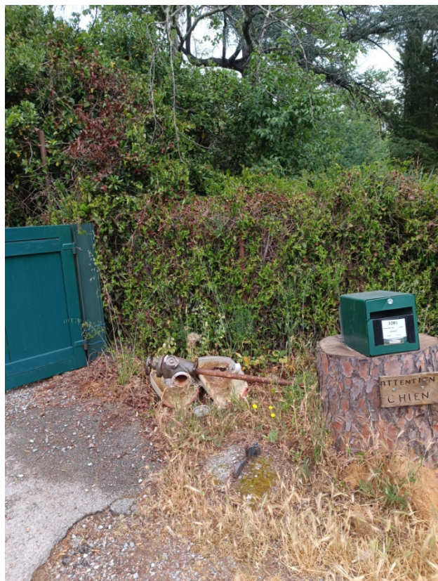
Borne incendie ramenée à la MF Louve
