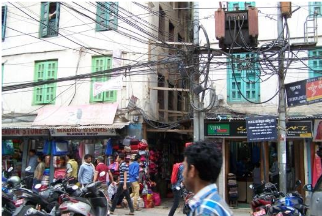
Les fils électriques...Enchevêtrés
